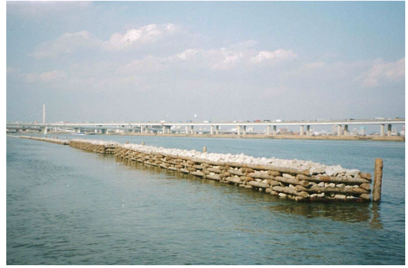
国土交通省 荒川(小松川地区) 1,2,3,4層建型(単独沈床)
