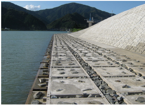
国土交通省 土佐川樋門（由良川） 1t植石タイプ
